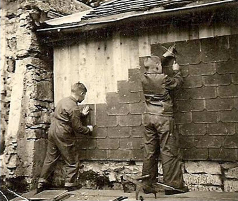
Hans Rudolf und Fritz KehrlI II bei Fassadenarbeiten an der Gerbergasse 12 (um 1963).
